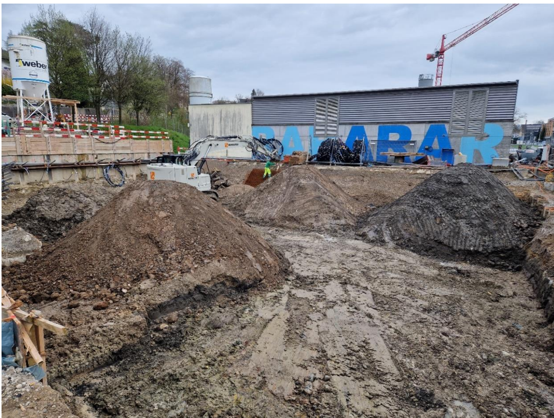
Abbildung 1: Triagiertes Aushubmaterial wartet vor der Abfuhr auf die Resultate aus dem Labor
