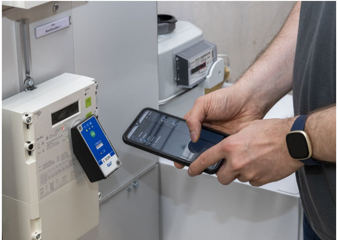
Rund 2000 Smart-Meter-Zähler wurden in Wetzikon installiert. Die Stadtwerke Wetzikon können dadurch den Verbrauch von Energie oder Wasser einfacher und schneller ablesen.
